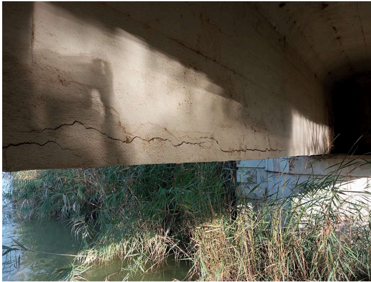
Imagen 4. Estado del hormigón (fuente: elaboración propia).
