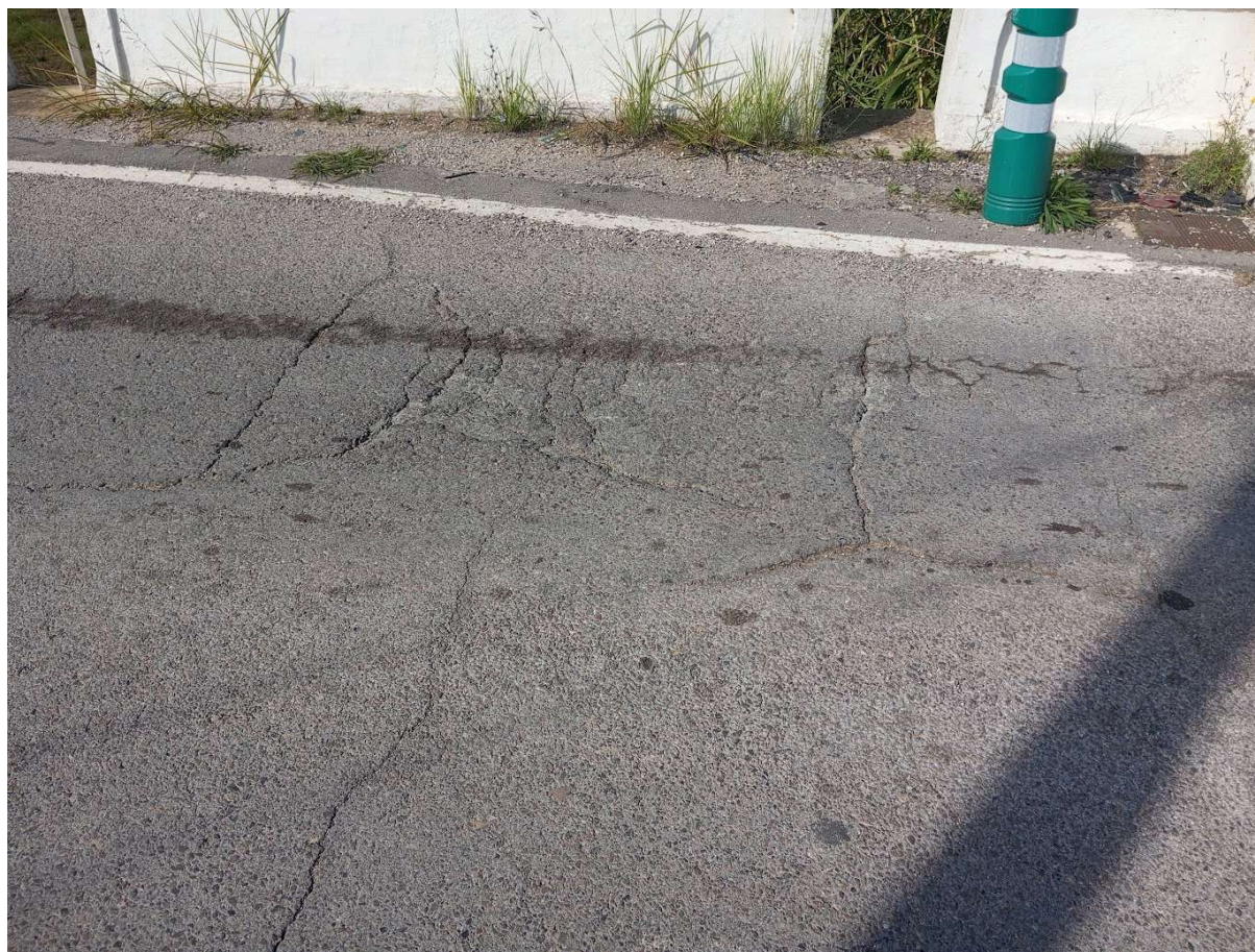
Imagen 6. Pavimento fisurado (fuente: elaboración propia).
