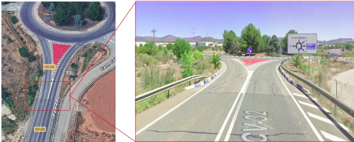
Figura 21: Desaparición del arcén en la zona sur de la glorieta situada al norte del paso superior. Fuente: Elaboración propia
