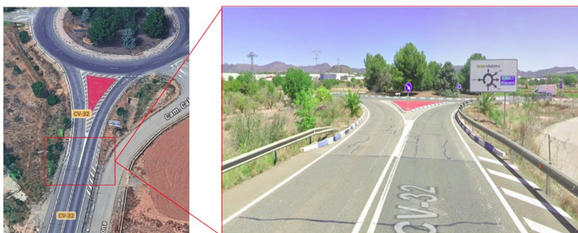
Figura 53: Desaparición del arcén en la zona sur de la glorieta situada al norte del paso superior. Fuente: Elaboración propia
