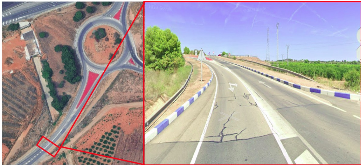
Figura 19: Desaparición del arcén en la zona sur de la glorieta situada al sur del paso superior. Fuente: Elaboración propia
