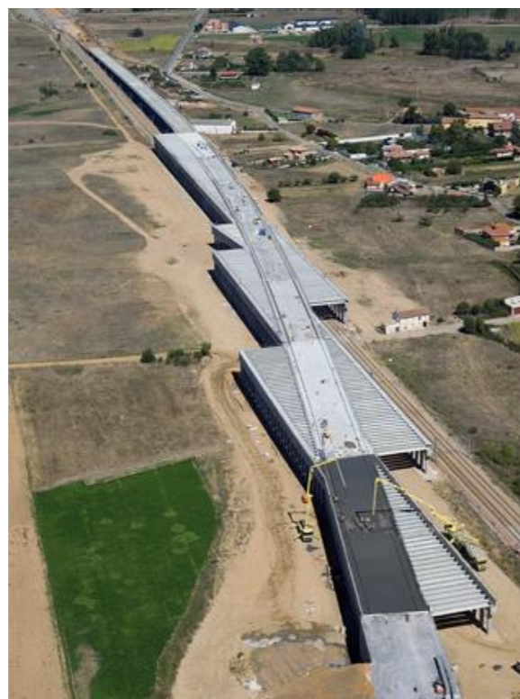
Figura 4. Puente pérgola de la LAV venta de Baños-León, subtramo Palanquinos - Onzonilla (León), sobre doble vía de ancho convencional Venta de Baños-Gijón (Fuente. CONSTRUBLOG, 2014).
